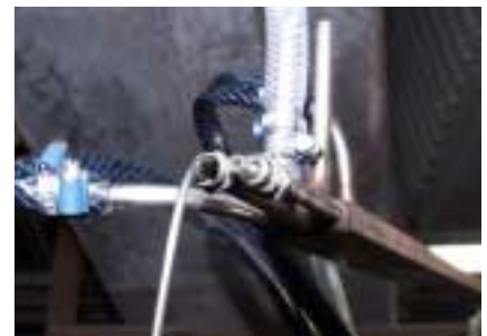
Sugpyrometern är lång och tung och kräver anslutning till både kylvatten och tryckluft.
