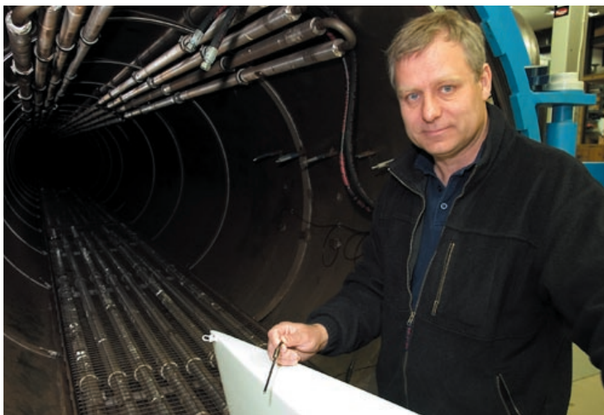
Per Wärn framför den 35 meter långa autoklaven. Jämn temperatur över hela sträckan garanteras av ånga och noggrann temperaturmätning med Pt 100-givare. Eftersom industriautoklavens atmosfär värms av ånga via värmeväxlare - ångrören är försedda med flänsar - behöver givarna med kablage inte vara ångbeständiga som t ex vid sterilisering.
