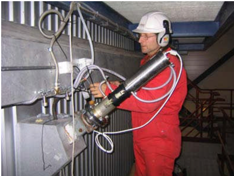
Exempel 2 En KT15.69 monterad i en cylindrisk kylanordning ansluts till kontrollsystemet i panncentralen.
