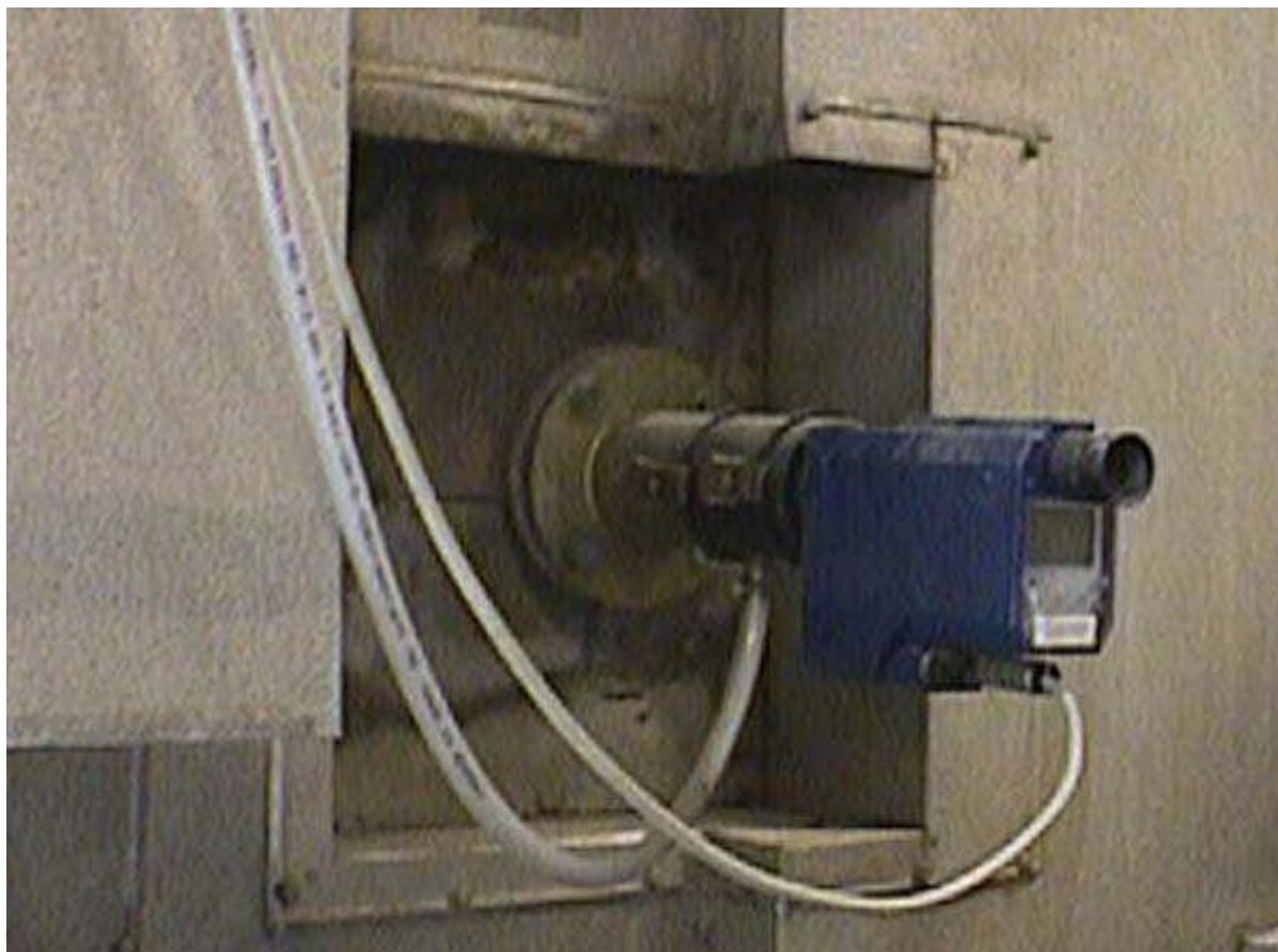
Exempel 1. Strålningspyrometer KT19.69 från Heitronics installerad i pannvägg.
